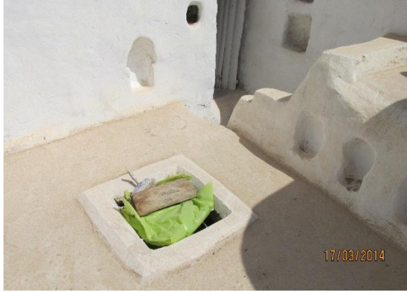
شكل رقم (27): سقف بسمك صغير مع شقوق
