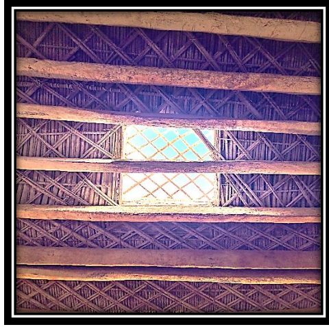
شكل رقم (15) صورة لفتحة الإضاءة والتهوية (تنفوت) في سقف الحجر أو الصالة الرئيسية (تمانحت).
